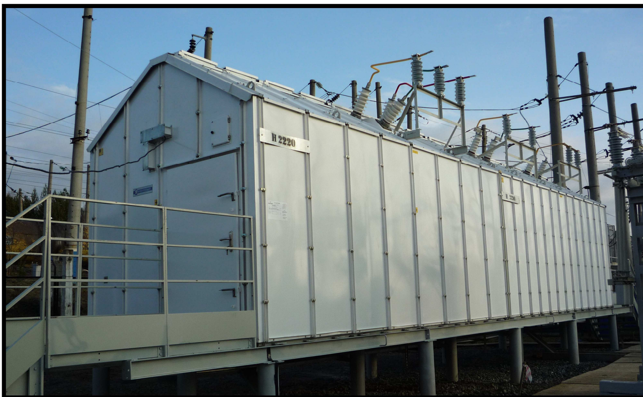
Рисунок 2 – КРУ СЭЩ-65 ЖД исполнения УХЛ1 в утепленной оболочке модуля электротехнических блоков.
