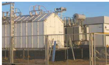
Закрытое распределительное устройство ЗРУ-СЭЩ 35/6 кВ
