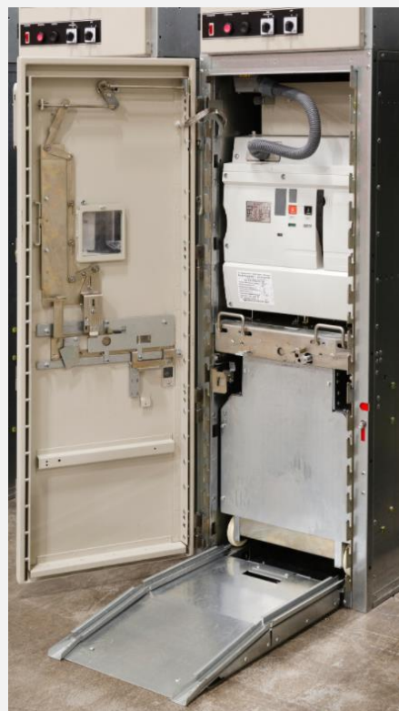
Рисунок 4 – Вид ВЭ в шкафу
